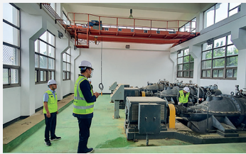
〈배수장 펌프 가동 점검〉
